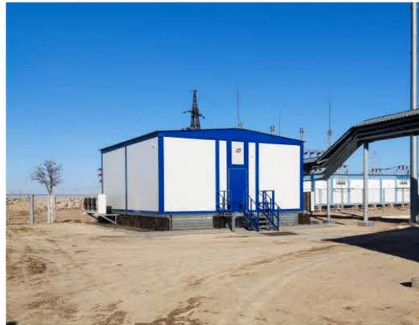
Автоматизация Блочно-кустовой насосной станции №5 в НГДУ-3.
