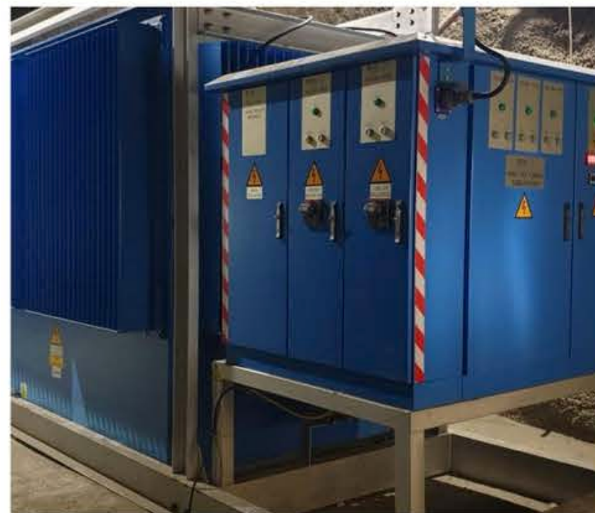
Шахтная трансформаторная подстанция 10/1кВ 1600кВА
