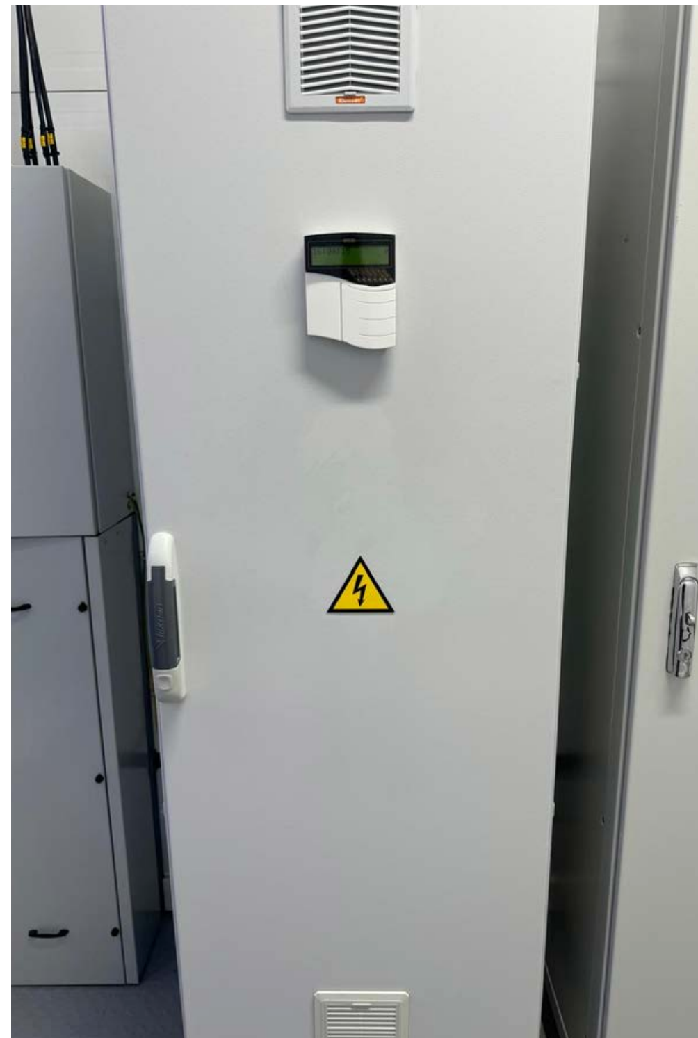
Щит охранной сигнализации
