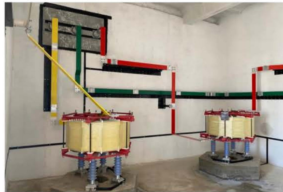
РЕКОНСТРУКЦИЯ ТОКООГРАНИЧИВАЮЩИХ РЕАКТОРОВ ТОР-10КВ ПС-220КВ «КУЛЬСАРЫ»
