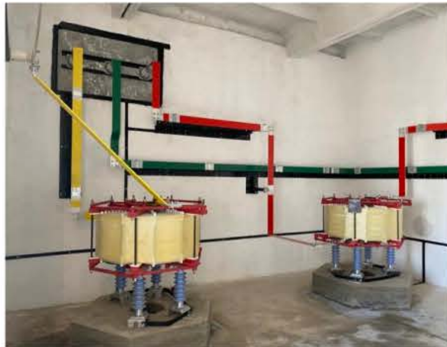
РЕКОНСТРУКЦИЯ ТОКООГРАНИЧИВАЮЩИХ РЕАКТОРОВ ТОР-10КВ ПС-220КВ «КУЛЬСАРЫ»
