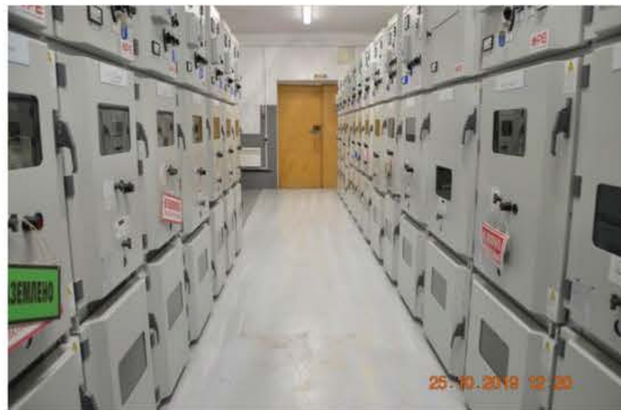
Модернизации ПС-110/10кВ «Восход» с заменой вакуумных ячеек 10кВ в ЗРУ-10кВ
