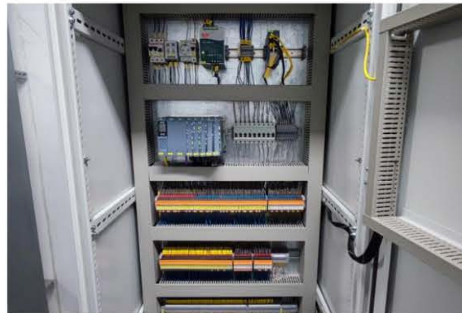
Автоматизация системы пожаротушения
