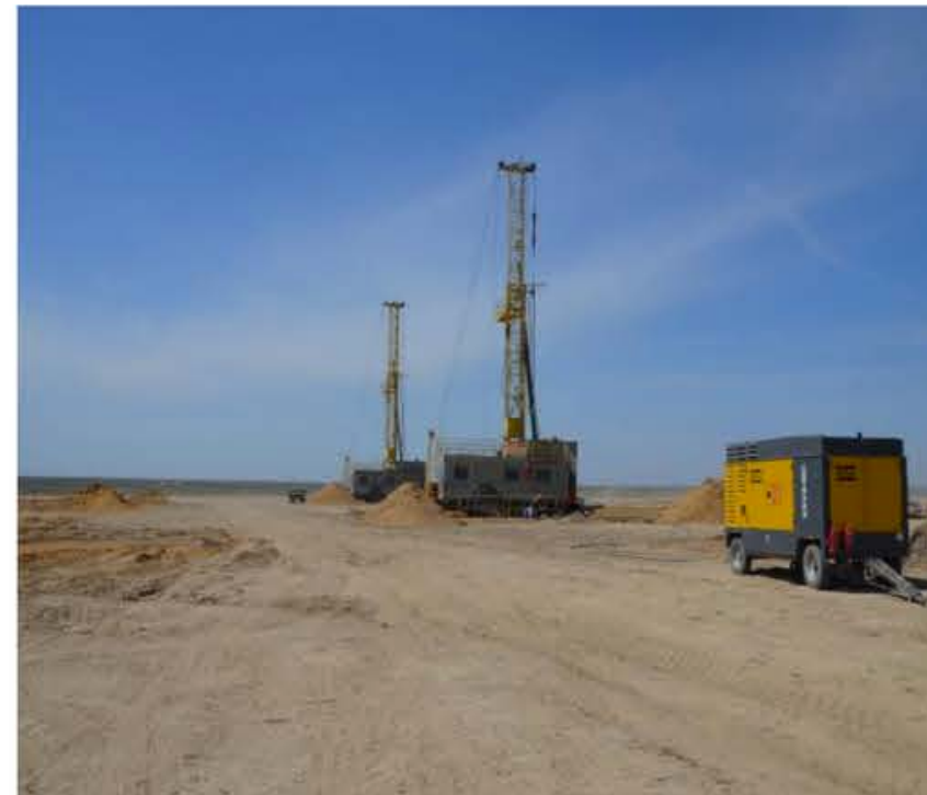
Разработка шкафов управления ЧРП буровых станков для разведки добычи урана
