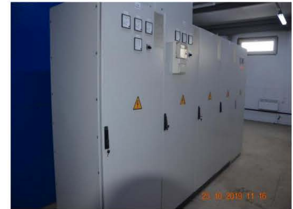
ИЗГОТОВЛЕНИЕ И ПОСТАВКА ЩСН, ШОТ, ШЗТТ, ШЗТН И ДР. НА ВЭС 10 МВт «ВОСТОК ВЕТЕР»
